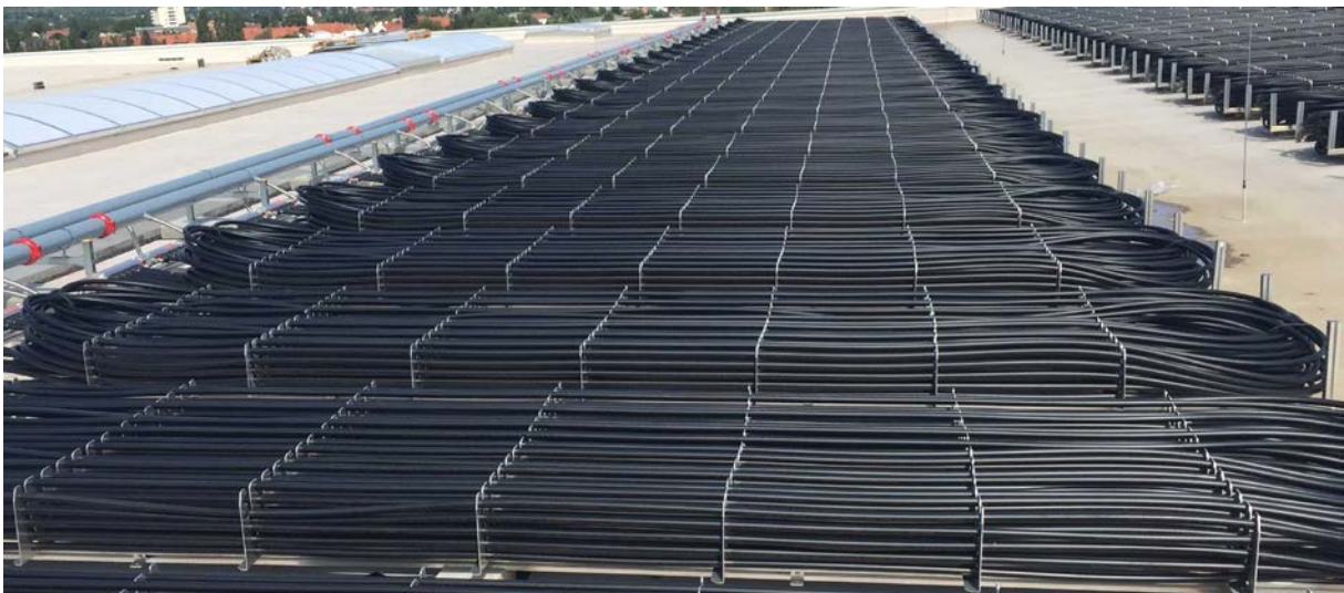
Abbildung 3-16: Kollektorfeld des SLK 600
