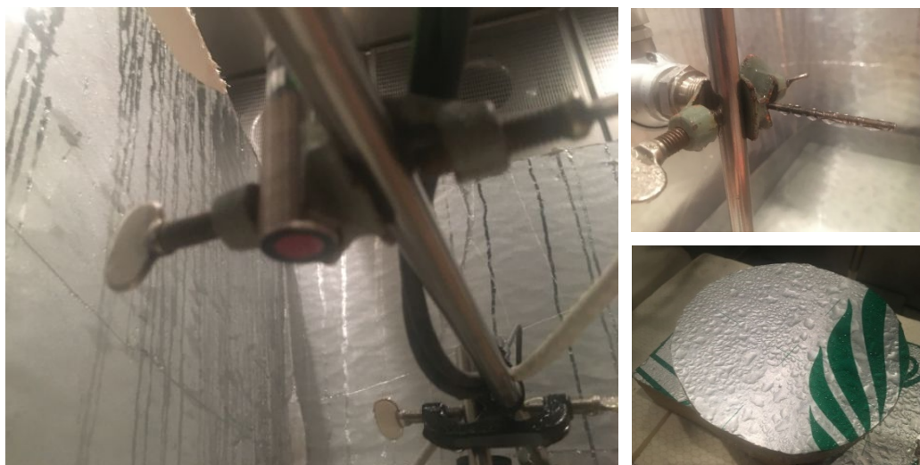
Abbildung 2-114: Oberfläche des U-Schall Sensors C (links) und Kondensatbildung am Temperaturfühler (rechts oben) und der als Reflektionsfläche dienenden PUR-Platte (rechts unten) während des „Klimatests“
