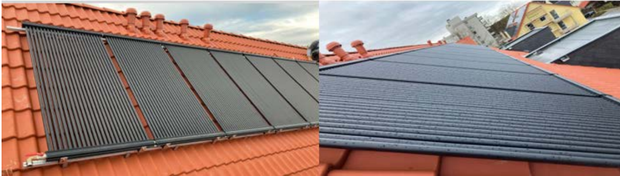
Abbildung 4-37: Thermische Sonnen-Luft-Kollektoren vom Typ SLK-Alu 2x1 installiert auf dem Schrägdach der Carports der Anlage 4
