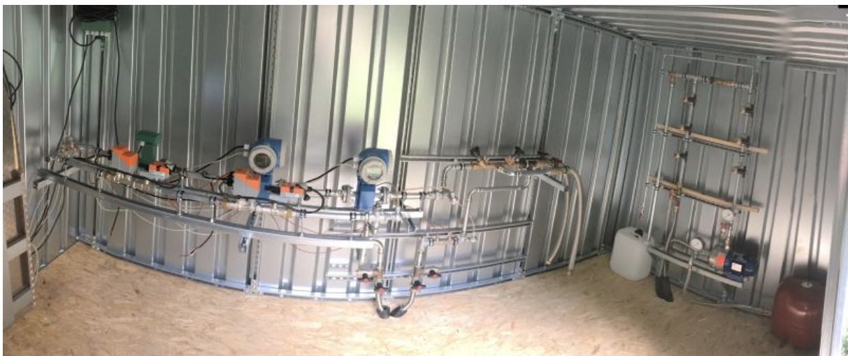
Abbildung 2-133: Messaufbau zur Bestimmung der Energieströme des Entzugs- und Regenerationswärmeübertragers des Versuchsspeichers und zur Überprüfung der Messergebnisse der Sensoren zu Bestimmung des Beladungszustands mittels Energiebilanzierung
