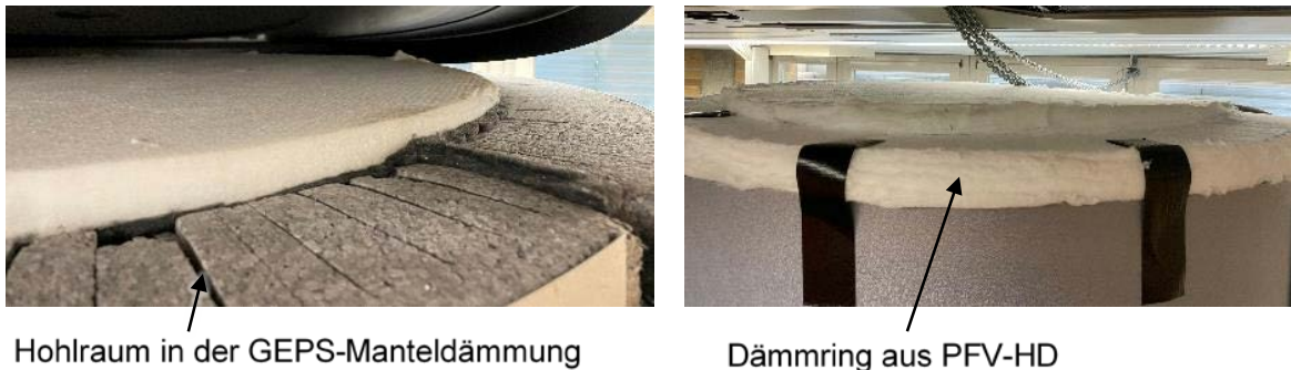
Abbildung 2-49: Abdeckung der Hohlräume in der GEPS-Manteldämmung
