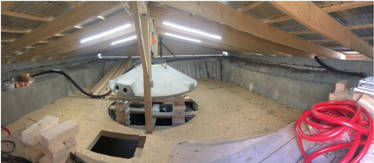
Abbildung 2-131: Aufbau Versuchsspeicher: Außenansicht mit angehobenem Speicherdeckel und umgebender Arbeitsplattform.
