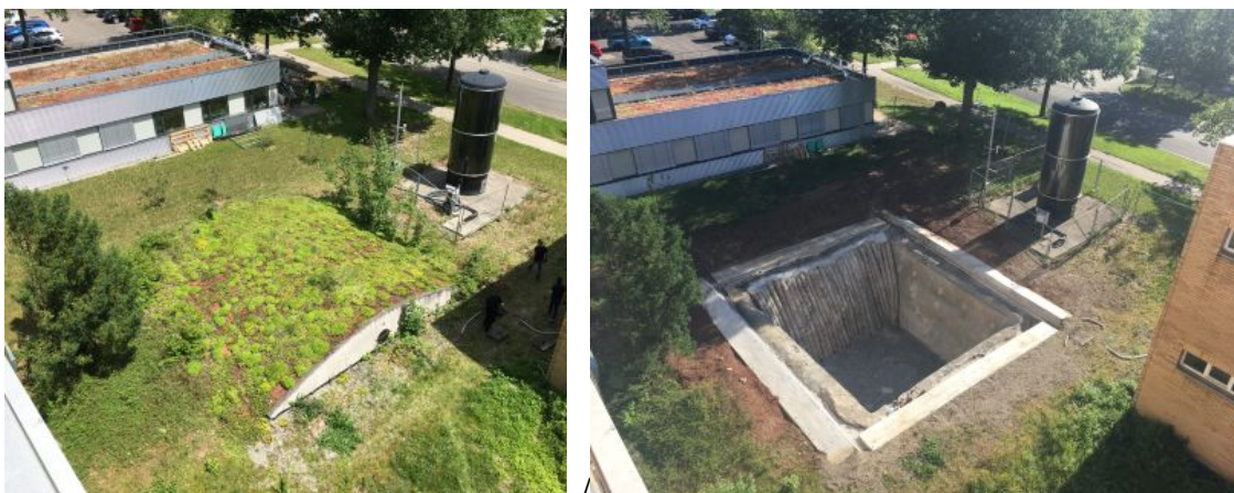
Abbildung 2-129: Außenlabor IGTE: Ausgangszustand mit Heißwasser-Erdbeckenspeicher (links) und zur Einbringung des Eisspeichers vorbereitete Baugrube (rechts)
