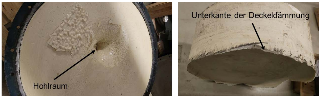
Abbildung 2-68: Deckeldämmung aus PUR für Wärmedämmung 2. Links: Hohlraum; rechts: fehlende Teile in Unterkante der Deckeldämmung
