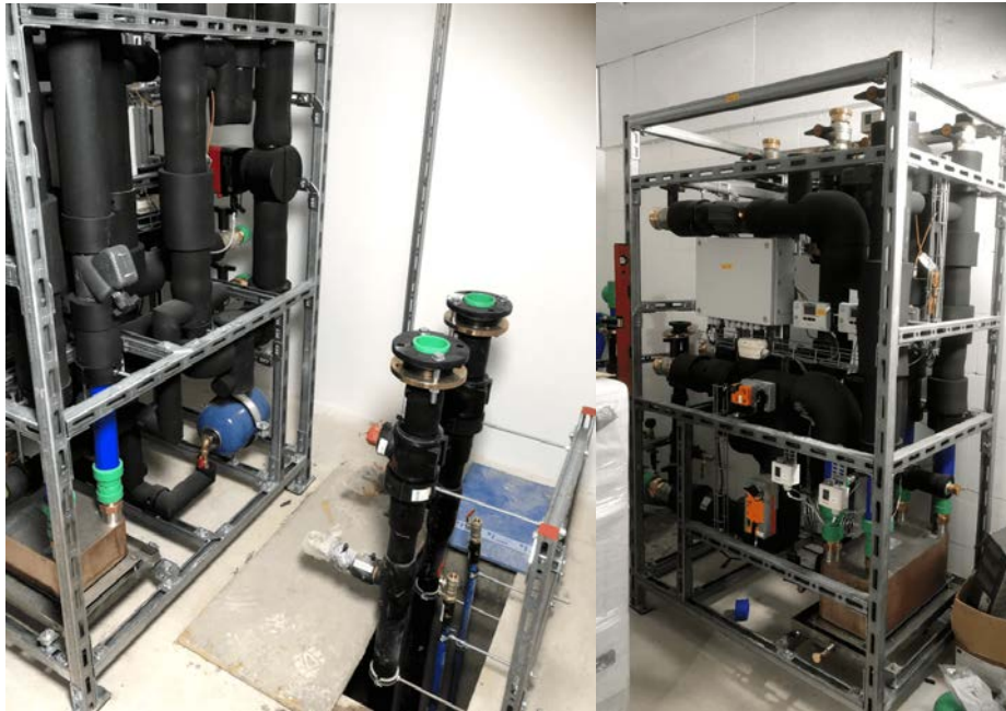
Abbildung 4-21:Hydraulikmodule und Anschlussleitungen an das kalte Nahwärmenetz in einem der Mehrfamilienhäuser
