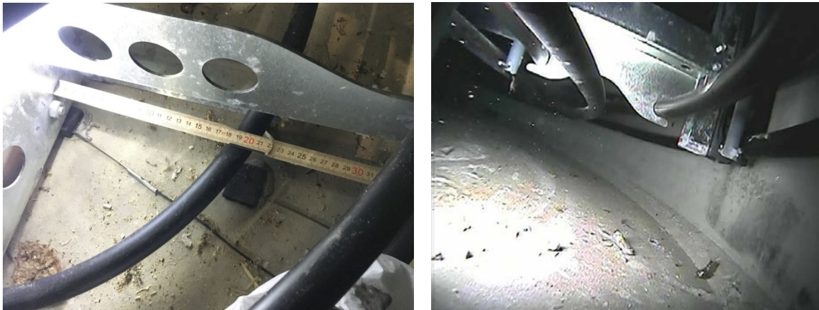
Abbildung 2-163: links: Position der untersten Ebene der Entzugsrohre im originalen Zustand bei Auslieferung durch die Fa. VCS. rechts: Position der untersten Ebene der Entzugsrohre im angehobenen Zustand im Versuchseisspeicher
