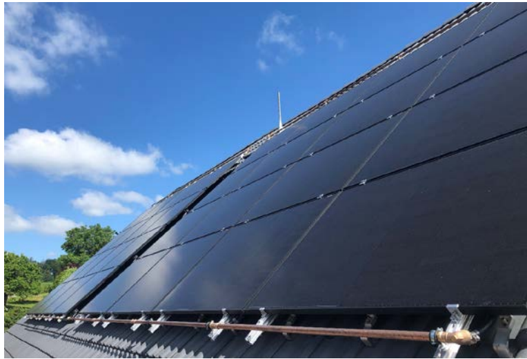
Abbildung 4-33: Kollektorfeld der Anlage 3 mit PV-Luft-Kollektoren vom Typ Dualsun Spring
