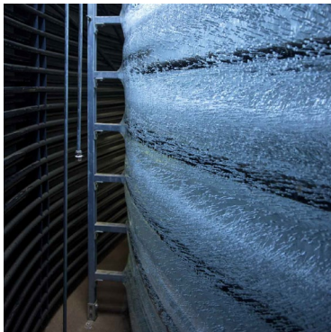
Bild: Eisbildung im Eisspeicher. Quelle: Viessmann
