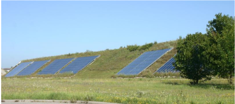
Abb. 3: Kollektoren auf dem Lärmschutzwall Ost
