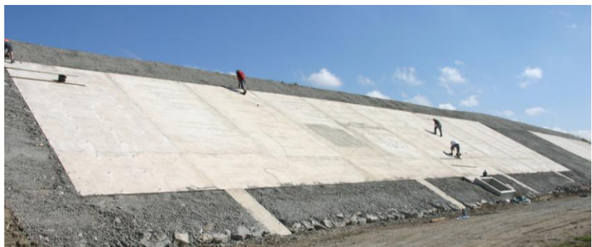
Abb. 4: Kollektor-Unterkonstruktion Lärmschutzwall West
