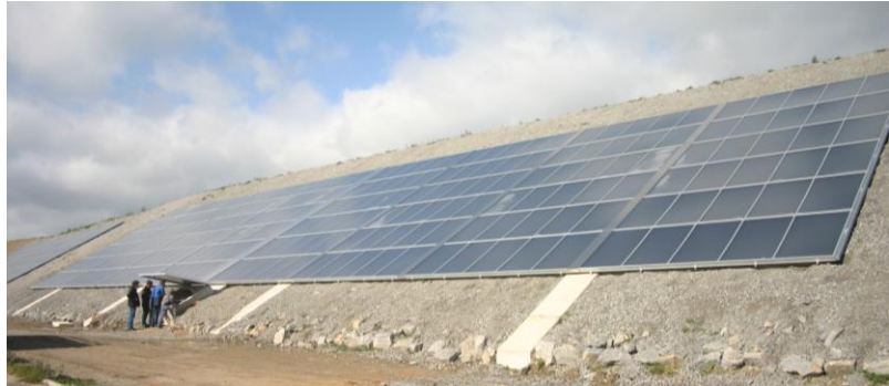
Abb. 5: Kollektoren auf dem Lärmschutzwall West
